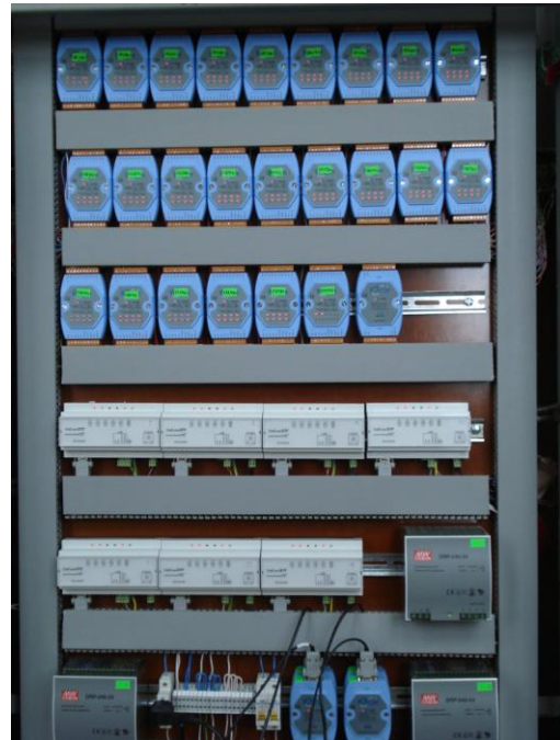
Шкаф связи (коммутатор)
